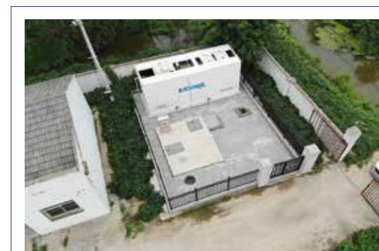
盐城市响水县生活污水处理项目
