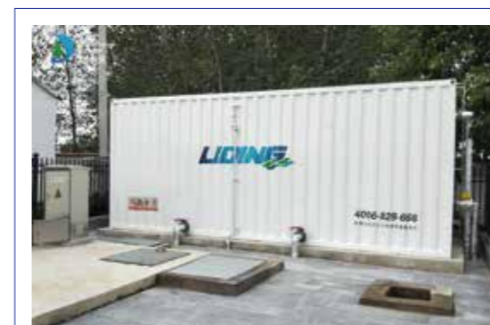
盐城市响水县生活污水处理项目
